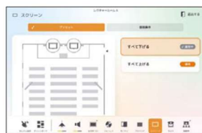
⑤スクリーン制御 スクリーンのプリセット操作、昇降を行います。
